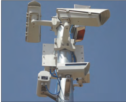
Infrarotmelder und Video-Kameras sowie optischer Alarm auf ca. vier Metern Höhe
